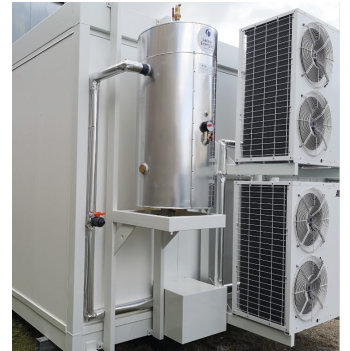
Deux chillers 25kW avec ballon inertiel monté sur un shelter (La Fab' MDC Ecus)
